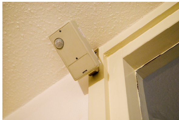
Een van de sensoren in een woning
